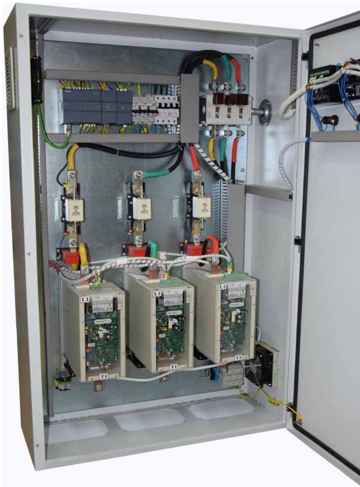
Рис. Б6 Фото шафи керування установкою УБ СТВ 22 з ННЛК
