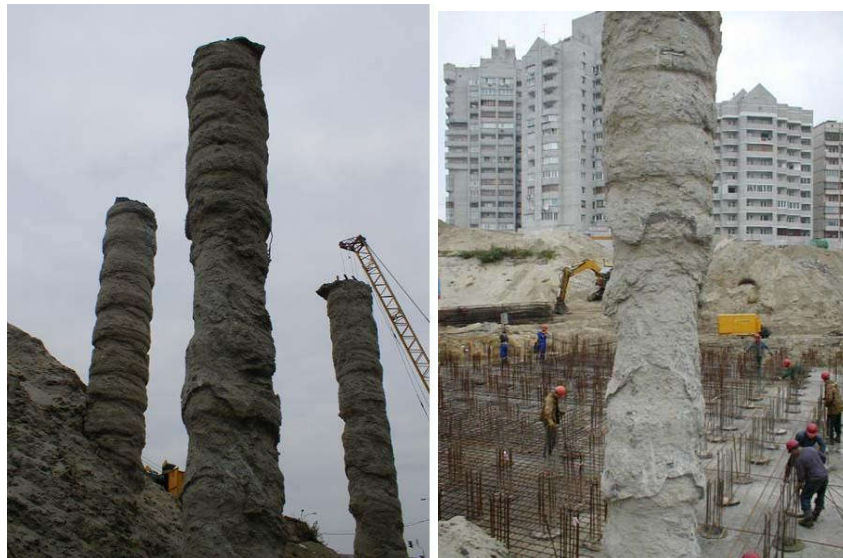
Рис. 1.11 Дефектні БП на будівельних об'єктах м. Києва.
