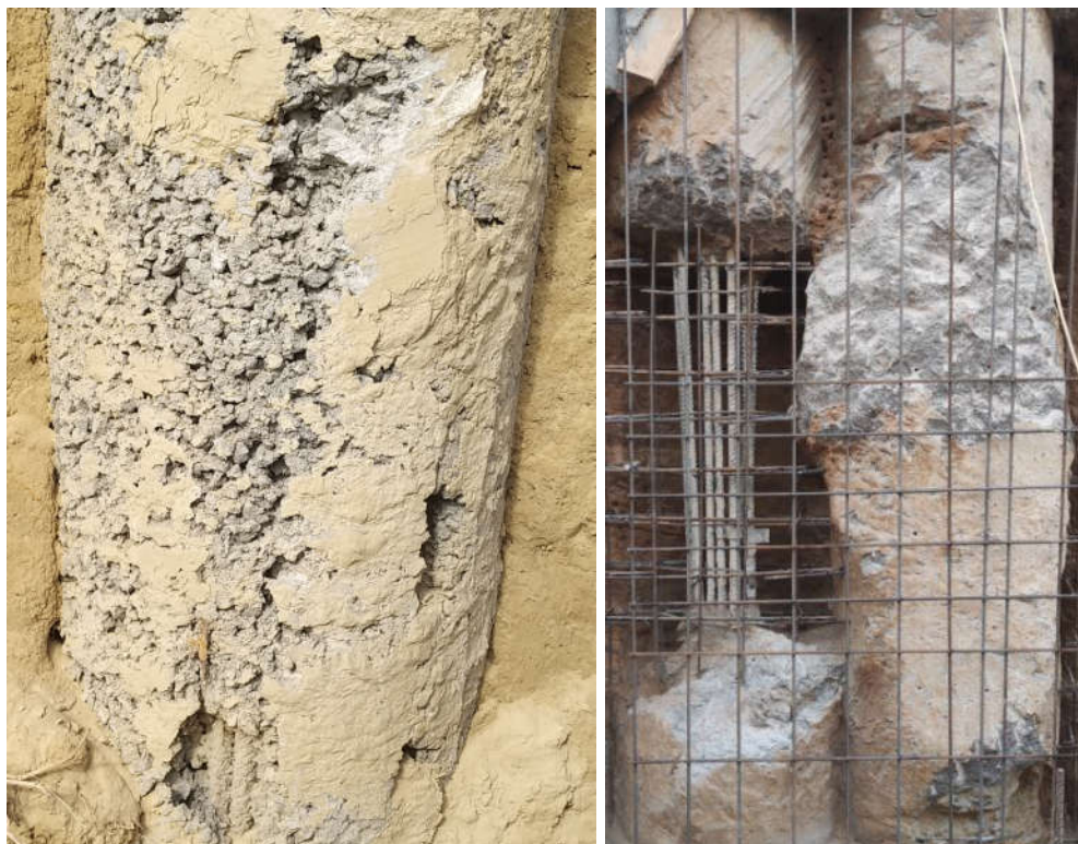
Рис.1.5 Розшарування бетону (порушення технології бетонування) БНП(а), розрив палі (б)
