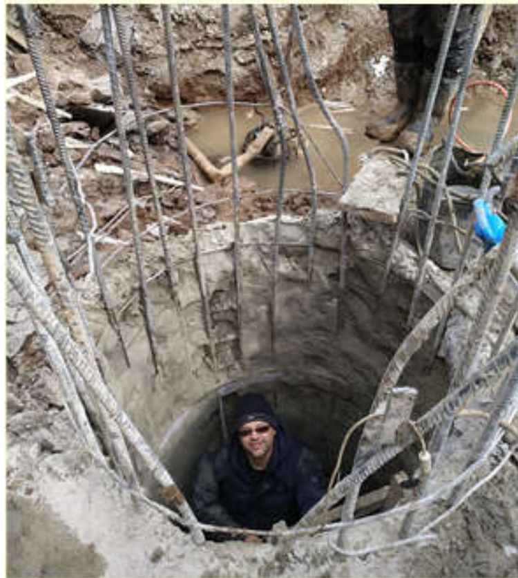
Рис. 1.9 Ліквідація наслідків значного дефекту бурового стовпа, якій виник внаслідок порушення процесу бетонування (будівництво мостового переходу в Полтавській області).
